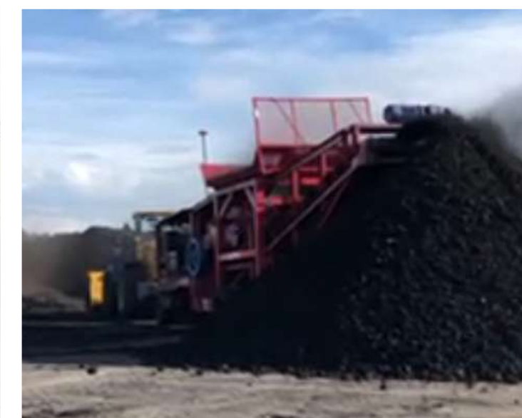
Coal grinder 2 ширхэг
